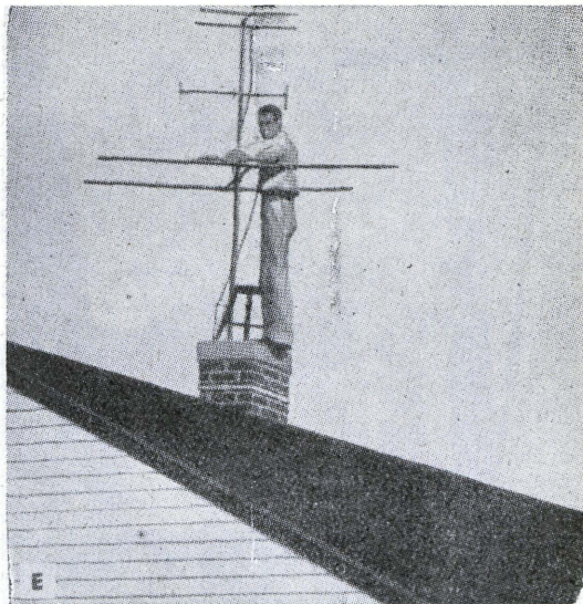
FIG. 23. - Installazione di un'antenna su di un camino: quando il camino consente un solido fissaggio e lo spazio circostante è libero, è il miglior modo per risolvere il problema.
